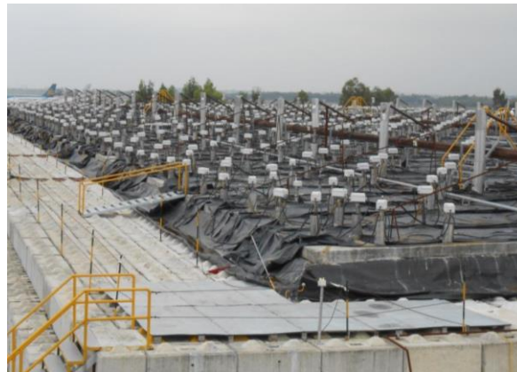
Lớp nhựa HDPE phủ phía trên nóc bê tông (Ảnh: CDM Smith)
