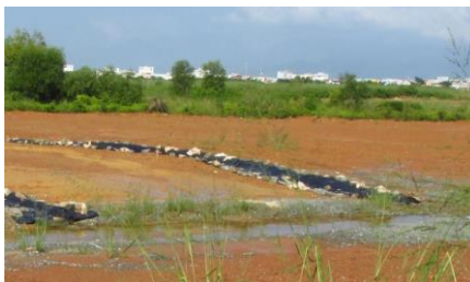
Phương pháp kiểm soát sự xói mòn (Ảnh: Tetra Tech)
