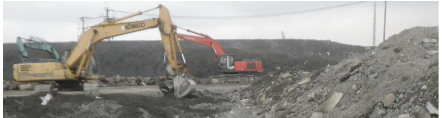
Loại bỏ vật liệu lớp đáy mố xử lý để đem đi xử lý. (Ảnh: CDM Smith)
