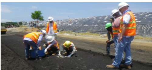
Trộn, nén và kiểm tra các đặc tính địa kỹ thuật của đất đã qua xử lý khi trộn với bê tông khối lượng nhẹ. (Ảnh: CDM Smith)
